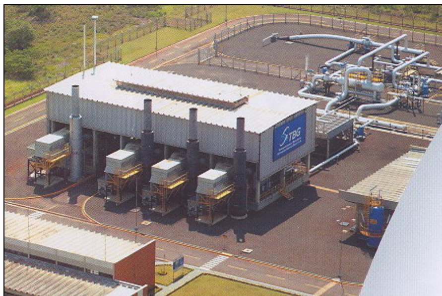
Figura A.1 - Vista aérea de uma estação de compressão do GASBOL. Fonte: TBG, 2004.
